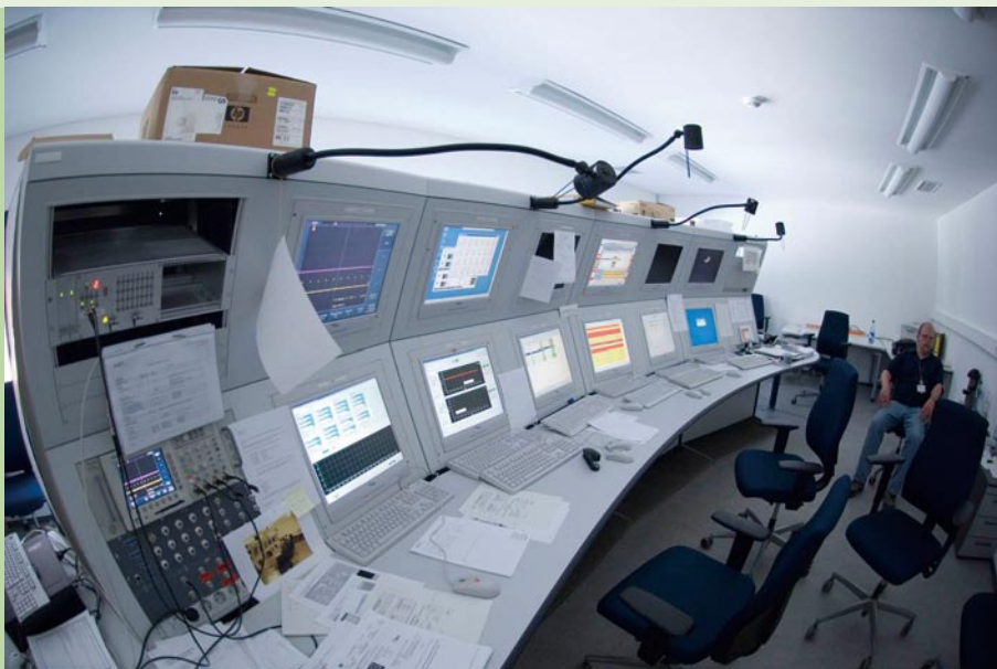
Pupitre de commande de l'installation du HIT.
