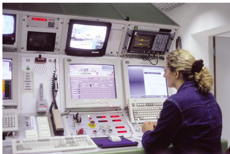
Fig. 31 : Tableau de commande de la salle de commande de l'unité de thérapie (TKR). Au centre, l'écran de commande principal.
